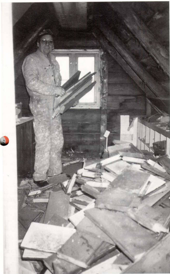
Før: Einar Berge Hansen starter rivingen og sørger for at det meste blir til ved. Foto: Willy Hovland.
